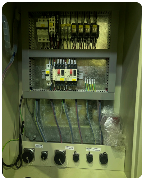
↑ Внутреннее устройство электрошкафа
