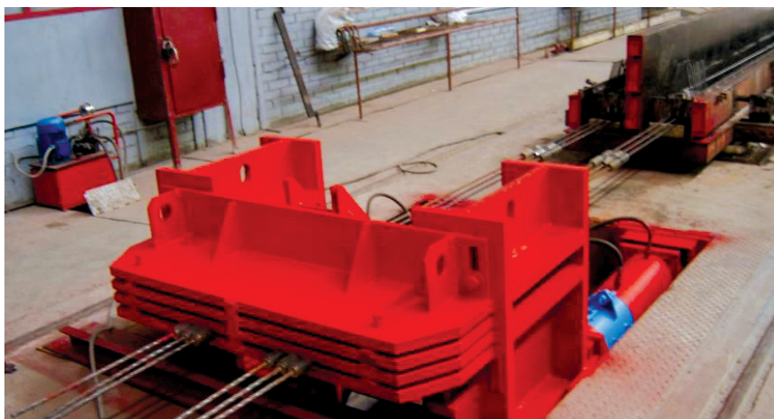
Стенд производства преднапряжённых Ж/Б конструкций
